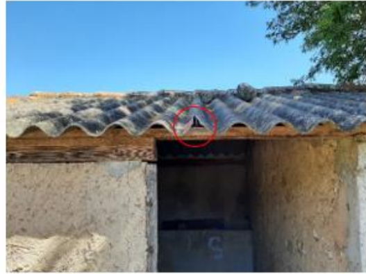
Plaque fibrociment fissurée
